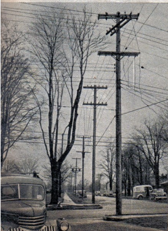
← Fernsprechfreileitungsnetz, im Vordergrund Wagen für Baupersonal
